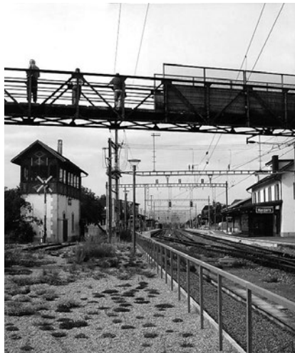
La passerelle de Chiètres fait partie d'un ensemble protégé avec le poste d'aiguillage.
