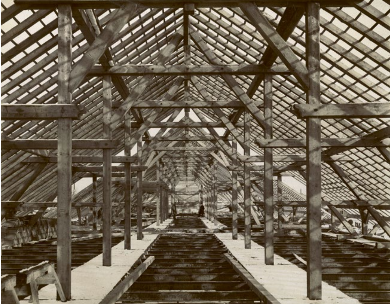
Charpente de l'étable en 1903, construite par François Meuwly de Fribourg. Dachgebälk des Stalls von 1903, erbaut von François Meuwly aus Freiburg.
