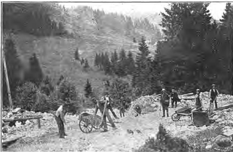
Räumung des vom Hohbergbach herbeigeführten Schuttes nach dem Hochwasser vom 15. August 1915.
