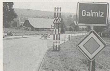
Gleichzeitig mit der Fertigstellung des Trottoirs werden auch Eingangsporten an der Dorfeingängen errichtet, um den Verkehr zu beruhigen.
