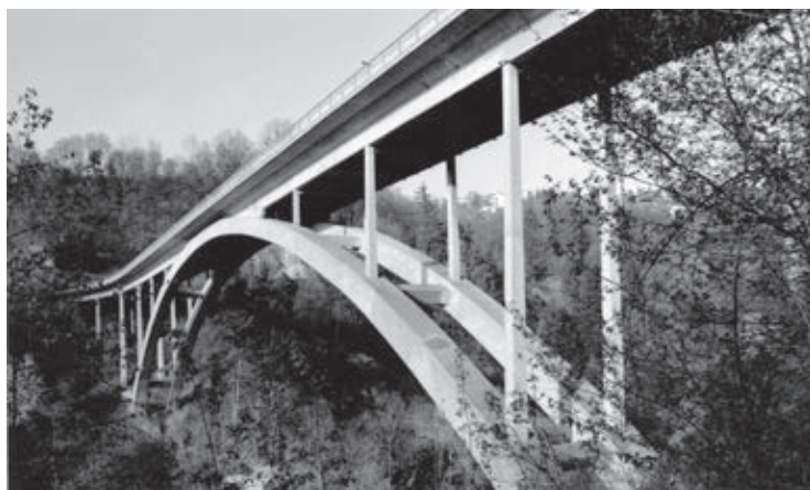
Galternbrücke in Freiburg, 1959 bis 1960, Ingenieure Henri Gicot und Pierre Brasey mit Hogg-Mons in Freiburg und Zschokke in Genf.
