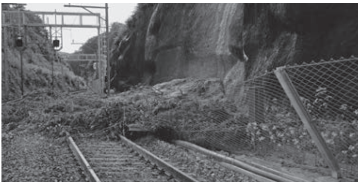
Erdrutsch bei Flamatt.
