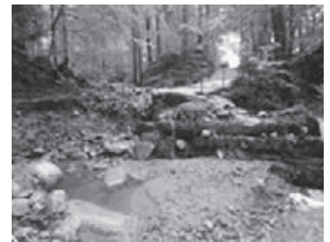
Aufgrund der grossen Wassermassen, welche der Limbach führte, wurde ein Teil des Weges vor der Brücke vollständig weggespült. Bild zvg
