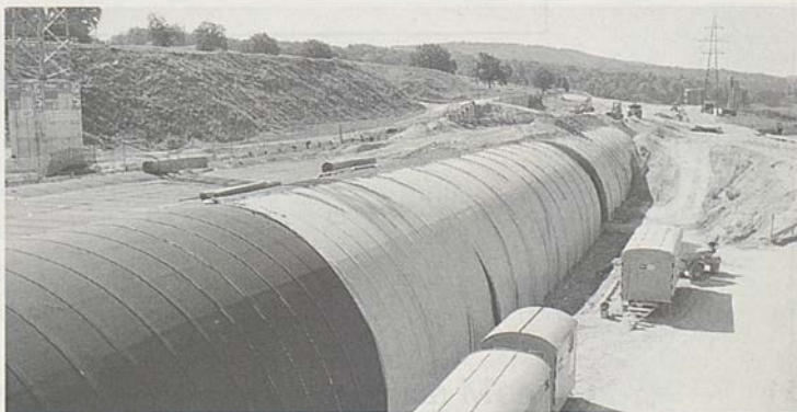
Der im Tagbau erstellte Tunnel der A1 bei Murten geht seiner Vollendung entgegen.
