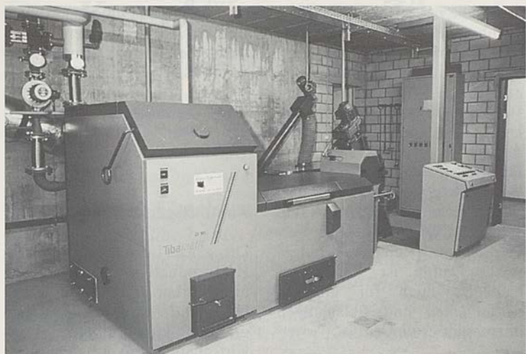
Vollautomatische Holzschneitzelheizung (Foto TIBA, Bubendorf)
