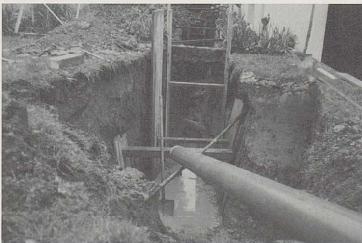
ARA-Anschluss durch ein Tulpen- und ein Rosenfeld
