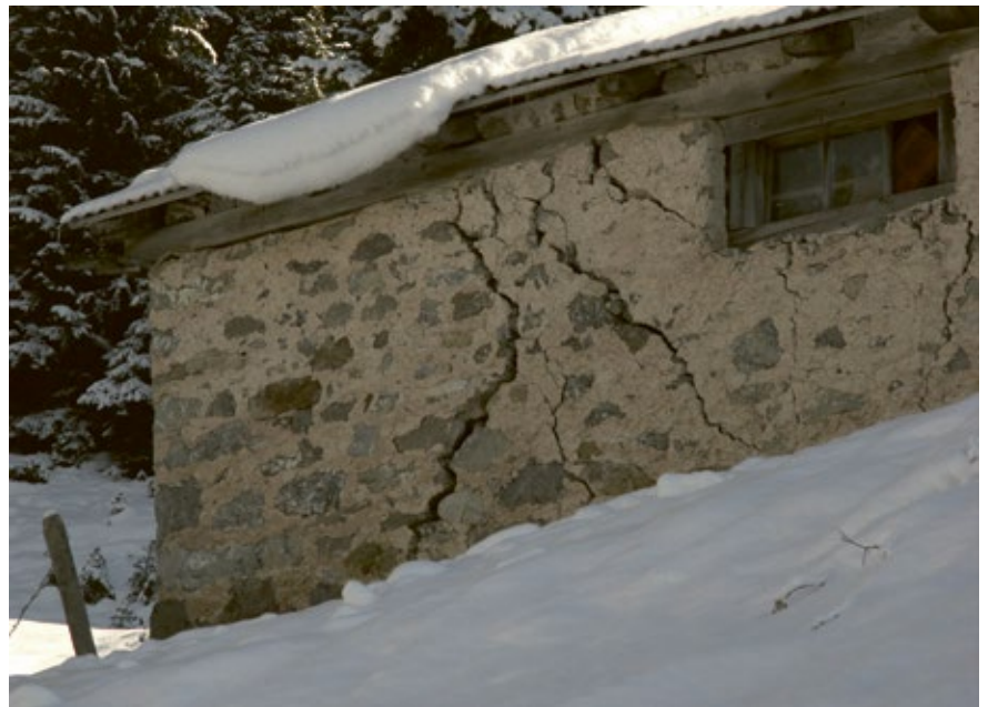
Le chalet fissuré du Pâquier des Vernes.
