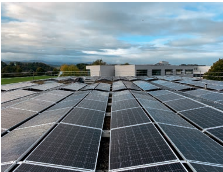
Die neue Photovoltaikanlage an OS Wünnewil.
