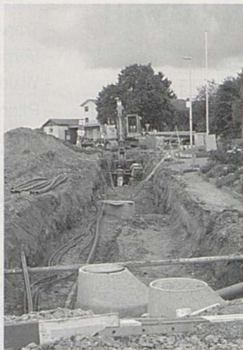
Auf der Strecke Schleif–Zum Kehr wird das Leitungssystem sowohl für die Trink- wie auch die Abwasser-versorgung erneuert.
