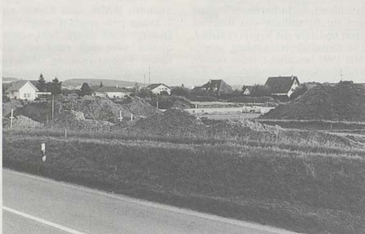
Mit der Überbauung des neuen Quartiers «Zentrum» dürfte sich die Einwohnerzahl auf über 200 verdoppeln.
