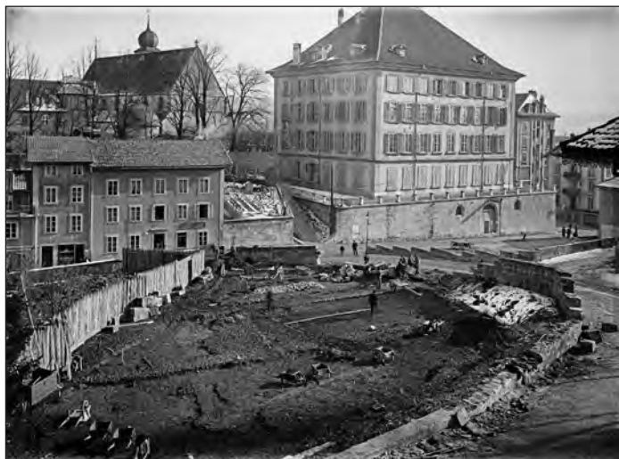
Les travaux précédant la construction de la BCU en haut du Varis vers 1907-1908. (Photo de Prosper Macherel)
