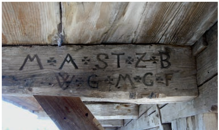
1) Verschiedene Handwerkersignaturen am Speicher Diesbach in Bürglen/Bourguillon. Die obere Zeile bezeichnet den Zimmermeister Adam Stulz von Ferenbalm, geb. 1712, der auch im Murtenbiet gebaut hat. Bild Jean-Pierre Anderegg
