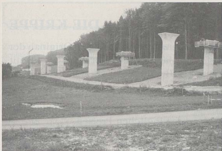
Der Bau der Autobahn N1 schreitet jetzt zügig voran. Hier der Bau des Viaduktes bei Löwenberg.
