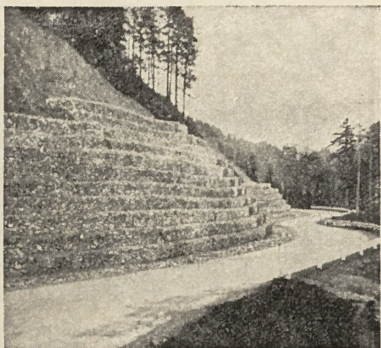
Route d'accès à la Station du Moléson Revêtements des talus en gabions métalliques
