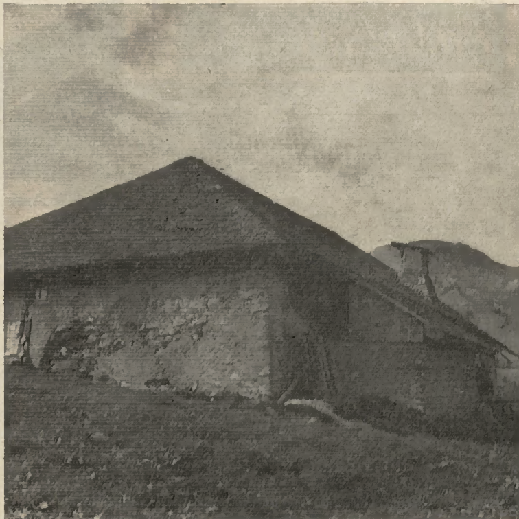
Le « chalet », terminus du tronçon bétonné. Tavillons et belle cheminée de bois ; mais aussi, caractéristique dégradation de la maçonnerie !
