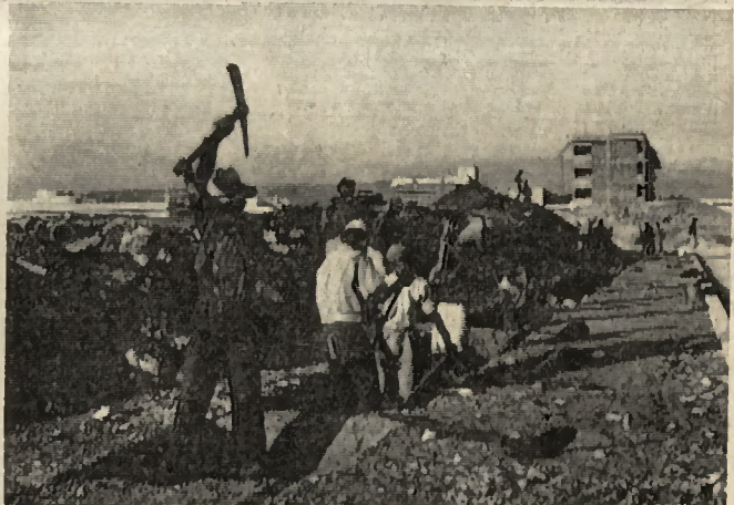
Tous les réseaux de canalisations de la ville sont à refaire. Les fouilles progressent à un rythme relativement lent, ce travail s'effectuant entièrement à la main.
