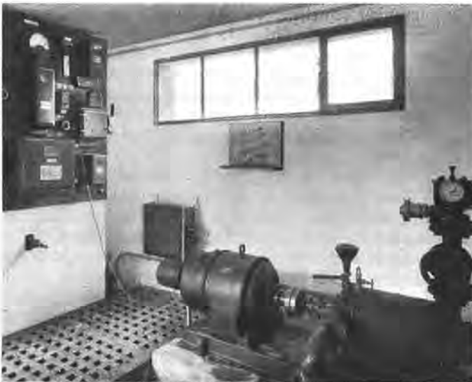
Das Pumpwerk. Das Pumpwerk bei der gefassten Quelle im hintern Hangbühl treibt das Wasser zum Hochbehälter im Magdalenenholz. Photo: P. Macherel, Freiburg.
