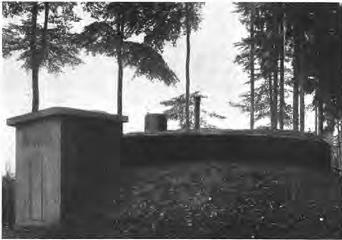
Der große Wasserbehälter im Magdalenenholz. Er besteht aus zwei ineinandergestellten, zylinderförmigen Behältern. Der innere faßt 100,000 Liter Trinkwasser, der äußere 200,000 Liter zu Feuerlöschzwecken. Photo: P. Macherel, Freiburg
