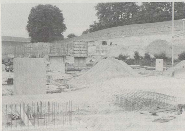
Die Bahnüberführung in Schmitten ist Teil der im Ausbau begriffenen Verbindungsstrasse zwischen Wünnewil und Dädigen (Stand der Bauarbeiten anfangs September 1988).
