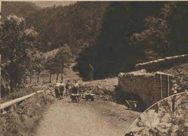
Oben: Auf einer Strecke von 30 Metern war die Kantonsstraße durch eine Schicht von Schutt und Steinen 1,50 Meter hoch gesperrt. Im Kreis: Auch diesen großen Steinblock hat der Pizalibach in seinem wilden Lauf mitgerissen.
