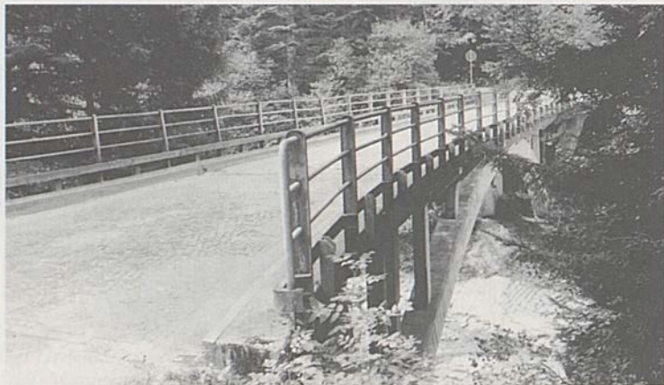
Die Roggeli-Brücke wurde nur provisorisch saniert.
