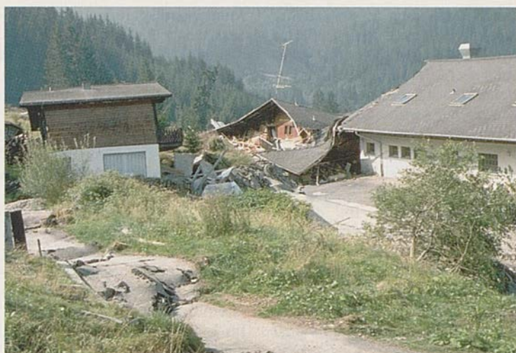
Hotel-Restaurant Falli Hölli im Juli 1994. Das Gebäude mit dem Restaurant ist bereits eingestürzt, dabei ist das Dach auseinandergebrochen. Rechts davon steht das Ferienhaus, das mit einem besseren Fundament die grosse Verschiebung «überstand». Im Vordergrund sieht man die Stauchwülste auf der Quartierstrasse, wodurch der Teerbelag emporgedrückt und zerrissen wurde.
