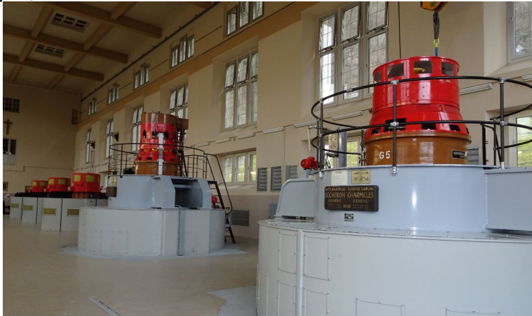
Im Vordergrund die 2 Kaplan turbinen
