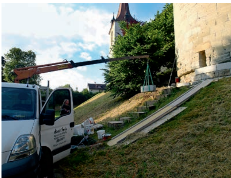
2017 fanden beim Pulverturm der Ringmauer Murten Sanierungsarbeiten statt. Der Lastwagenkran hebt ein neues Werkstück zum Turmsockel, um es dort einzufügen. Alle Bilder Daniel und Sabine Burla
