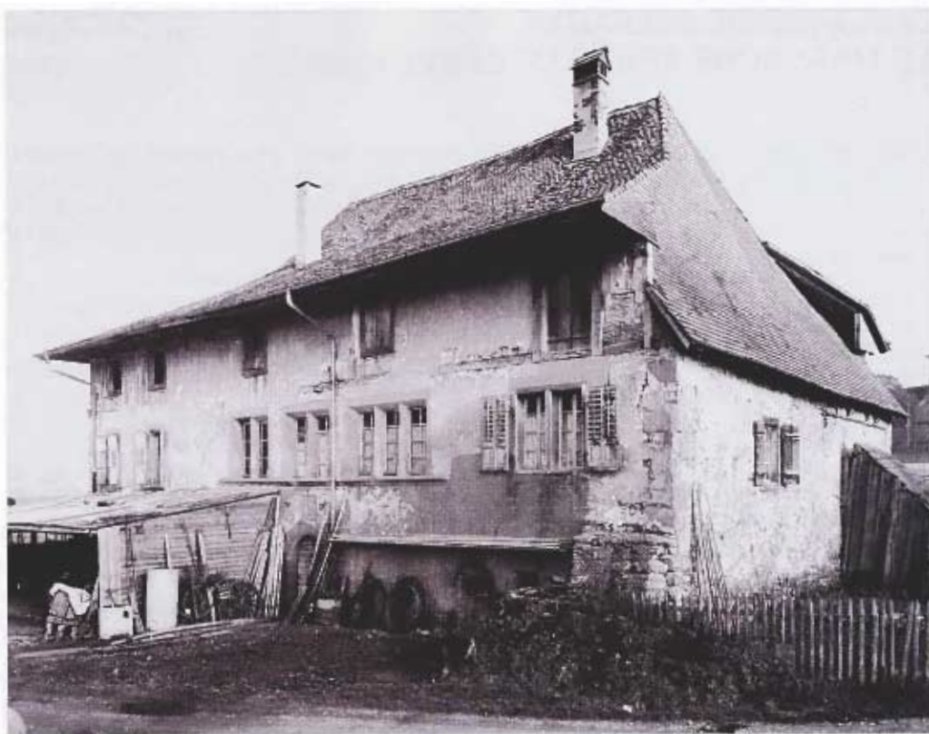
La façade Ouest avant les travaux! Elle ne payait pas de mine. Au rez-de-chaussée, la cave servait probablement d'entrepôt pour la blanchisserie de Jean de Lanthen-Heid. Le deuxième étage a probablement été ajouté à la fin du XVIII e siècle.
