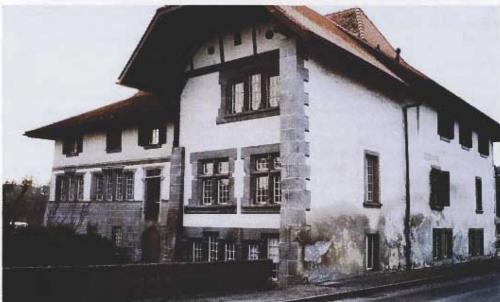
Après restauration: Le bâtiment a retrouvé sa splendeur. Mais la proxi- mité du trafic routier lui occasionne de gros dégâts en façade Nord. Elle a dû être refaite trois fois en 15 ans, en vain.
