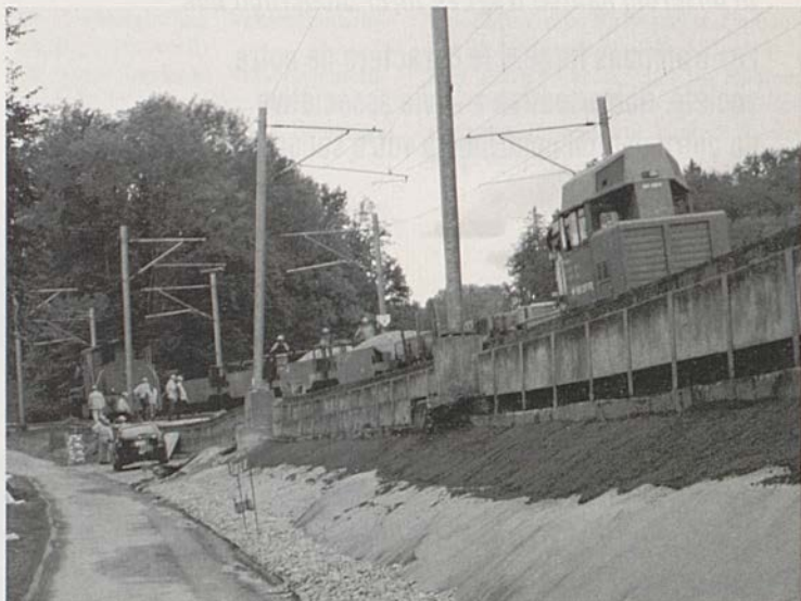
Die Eisenbahnlinie zwischen Wünnewil und Schmitten war infolge der Unwetter anfangs August mehr als zwei Wochen unterbrochen und wurde mit höchster Dringlichkeit provisorisch in Stand gestellt.
