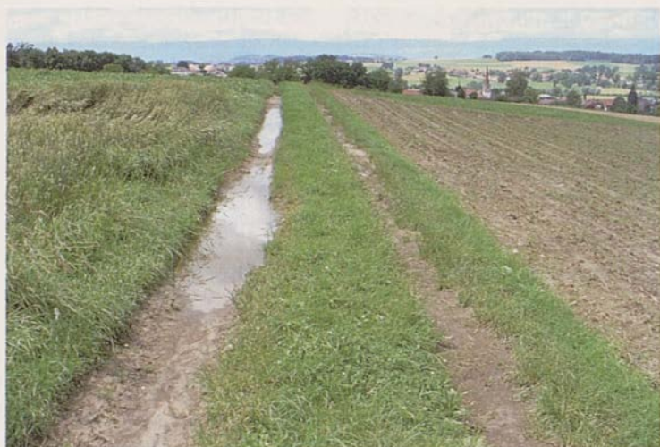
Sanierungsbedürftiger Weg auf der Bulliardhöhe in Gurmels (Foto Hubert Andrey)
