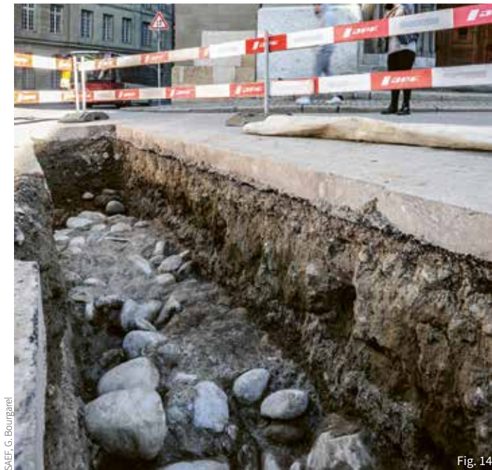
Fig. 14: Rue de la Cathédrale-Saint-Nicolas, parvis de la cathédrale: massif de fondations destiné à la tour avant le changement de parti, fin XIV e siècle.
