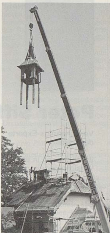
Bei der Dachrenovation der Kapelle in Berg wurde das Türmchen auf spektakuläre Art weggenommen.
